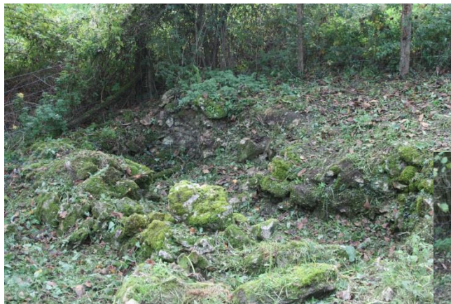
État de la fontaine avant intervention. Seules quelques parties de murs sont restées debout
